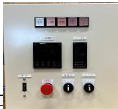
制御盤・コントローラ
