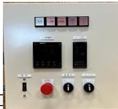
制御盤・コントローラ
